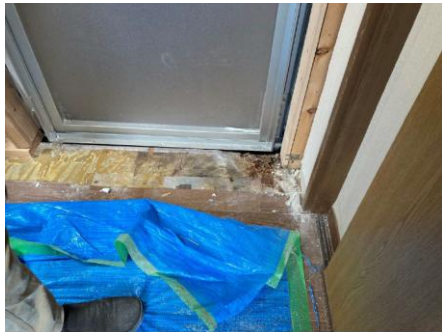
床材が湿気で腐朽している
