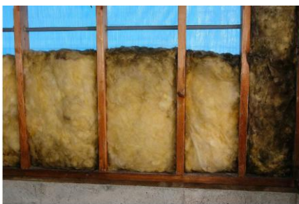
正しい気密施工が行われておらず柱や断熱材が腐敗
