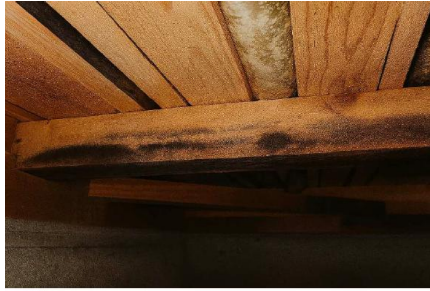
腐朽により黒くカビており、 構造の耐久性に不安が生じる
